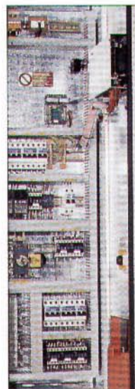
Quadro elettrico Electric box
